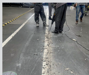
Abertura da junta
